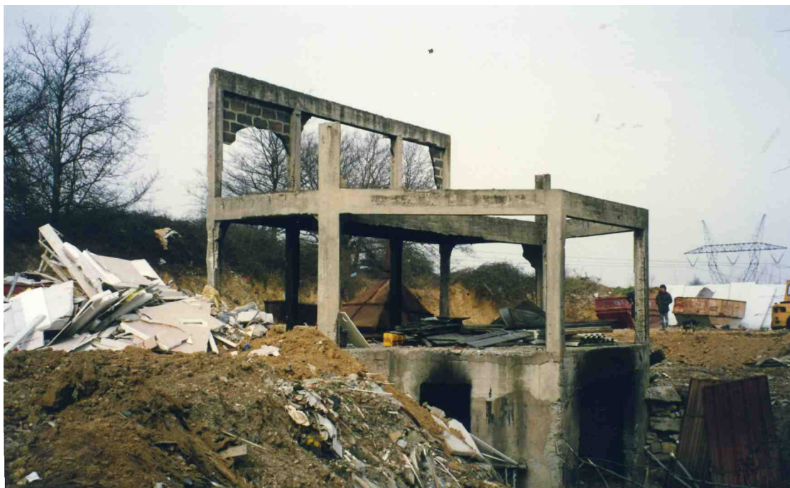
De nos jours, il ne reste rien de ce site qui est devenu une décharge de déblais et autres.
